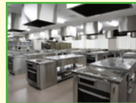
[調理実習室] 各テーブルにはIHクッキングヒーターとオーブンを1台ずつ設置。
